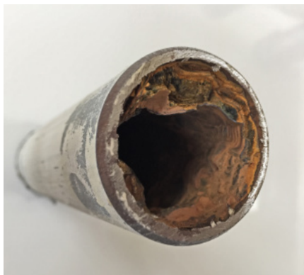
Tubo corrosivo e incrostato
