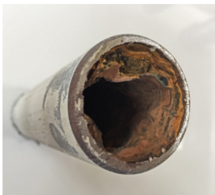
Tuyau corrodé et incrusté de dépôts calcaires
