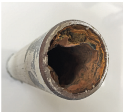
Tubo corrosivo e incrostato
