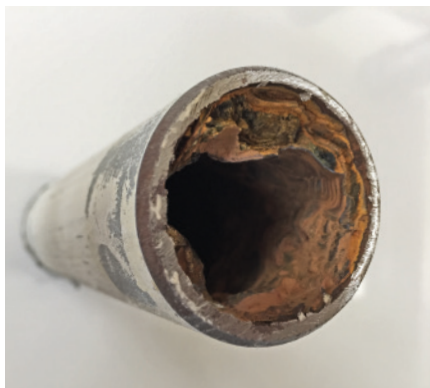
Korriertes und verkrustetes Rohr
