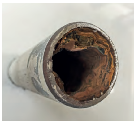
Tuyau corrodé et incrusté de dépôts calcaires
